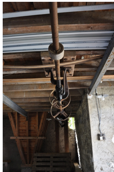
Détail d'un axe de transmission avec une chaise en H Phot. Yannick Milleret IVR82_20097300255NUCA
