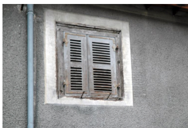
Baie de l'étage en surcroît avec encadrement de bois. Phot. Simone Hartmann-Nussbaum IVR82_20114201285NUCA
