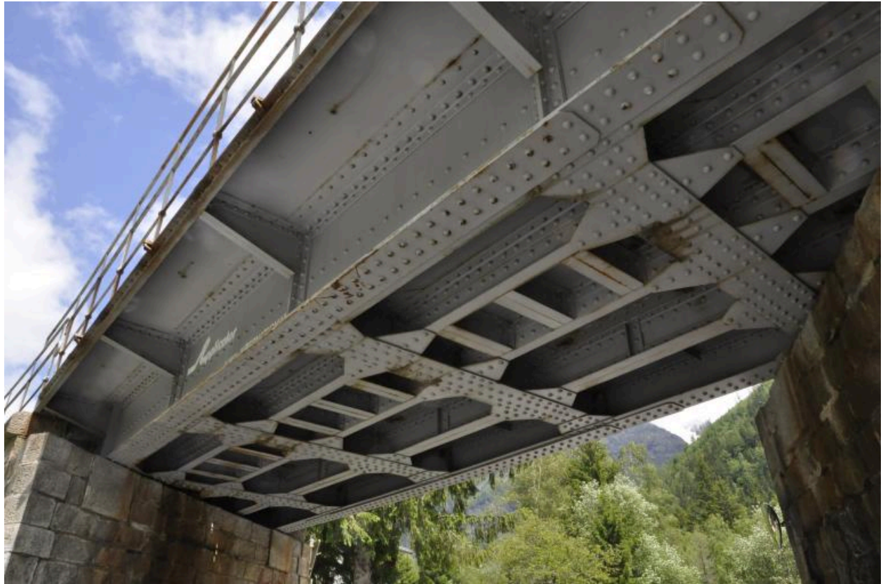
Armature du tablier métallique composé de deux poutres principales et des poutres de rive sous rails
