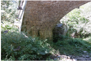
Pont des Doubines, détail culée rive gauche et intrados Phot. Pascale Renard IVR84_20207401515NUCA
