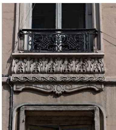
Elévisions ouest et sud, deuxième étage carré : appui de fenêtre souligné d'une rangée de feuilles d'acanthé Phot. Eric Dessert IVR82_20126901471NUCA
