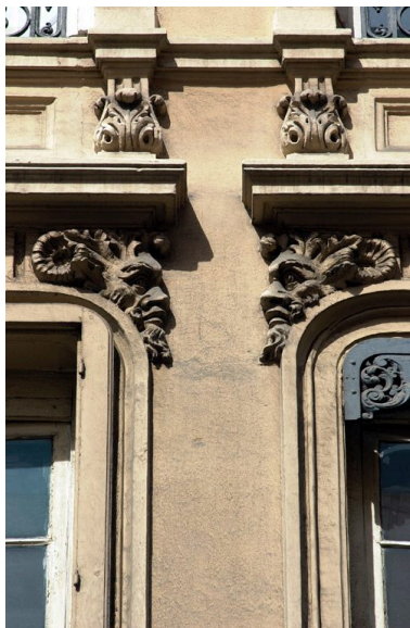
Elévation est, deuxième étage carré : masques affrontés ornant les fenêtres du deuxième étage carré Phot. David Chevallier IVR82_20046905263NUCA
