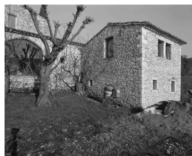
Elévation côté sud récemment restaurée (vue partielle) et corps de bâtiment remanié. Phot. Alain Franchella IVR82_19982600082X
