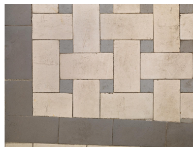
Premier étage, première chambre au sud : pavement de l'alcôve, carreaux d'origine Phot. Thierry Leroy IVR84_20216900898NUCA
