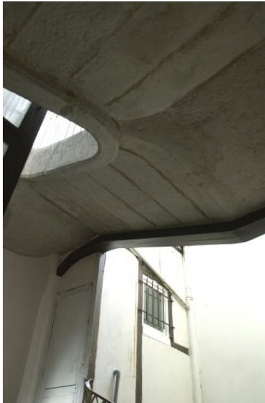
Escalier, vue du dessous des marches du cinquième étage Phot. Lore Derail IVR82_20036901401NUCA
