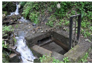
Vue de la prise d'eau. Phot. Clara Bérelle IVR82_20147303180NUCA
