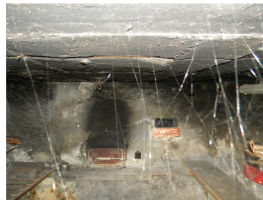
Vue de l'intérieur du four Phot. Jérôme Daviet IVR82_20137400959NUCA
