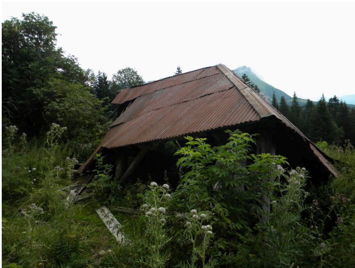
Vue de la toiture effondrée sur la partie étable à l'ouest.
