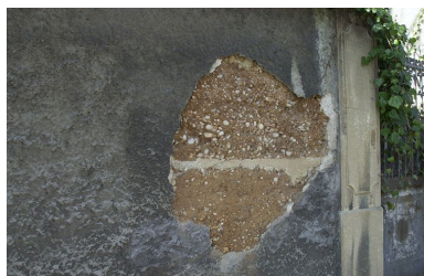
Détail du pisé de terre revêtu d'enduit du mur de clôture Phot. Véronique Belle IVR82_20036903180NUCA
