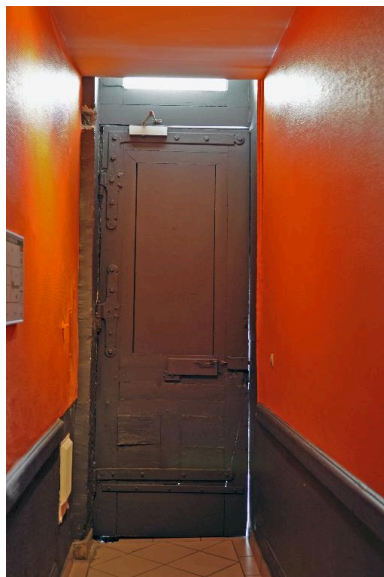
Vue intérieure : le revers de la porte d'entrée Phot. Catherine Guégan IVR82_20156901043NUCA
