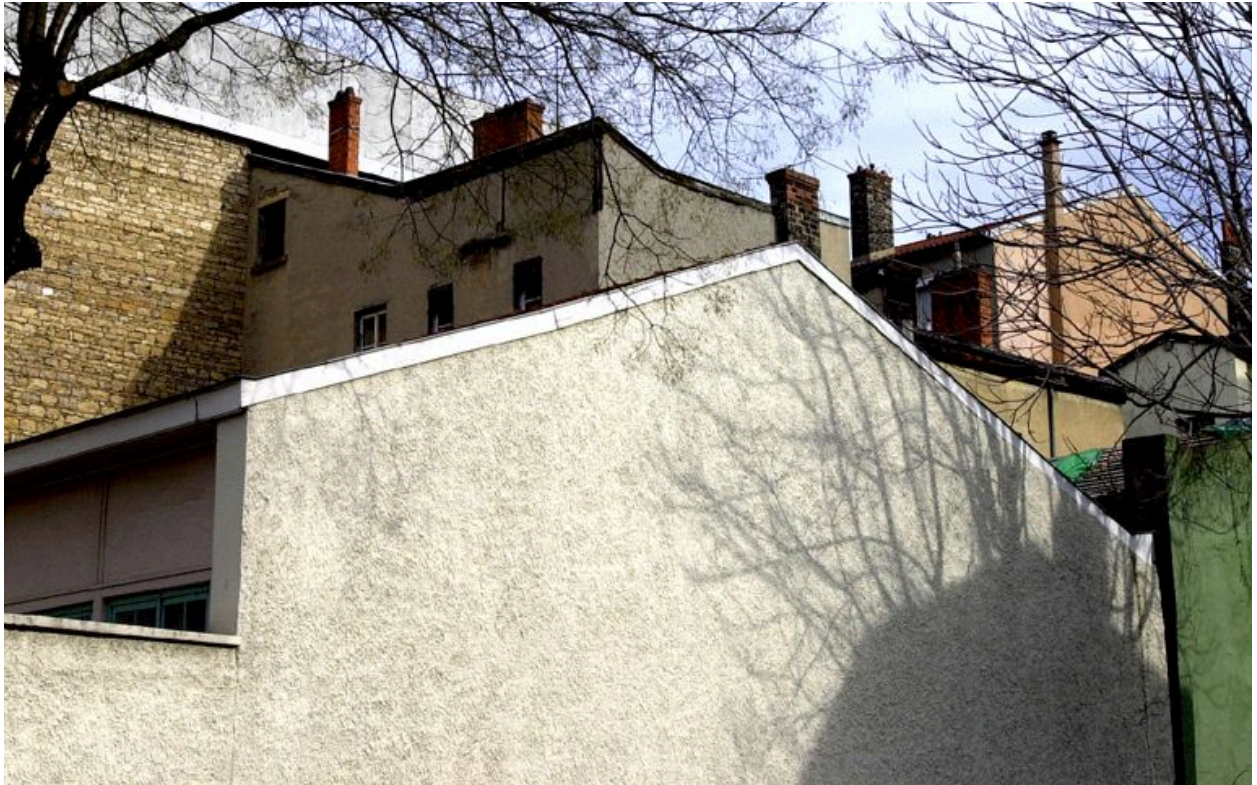
Détail de l'élévation postérieure du corps de bâtiment en fond de cour, depuis le terrain vague rue Gilibert.
