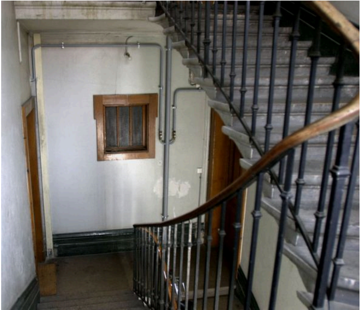
Palier du troisième étage et dernière vollée d'escalier vus depuis le repos
