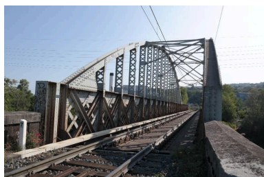
Pont ferroviaire de Vongy, vue du tablier et des garde-corps Phot. Pascale Renard IVR84_20207401539NUCA
