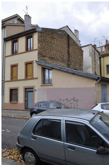
Vue latérale, moellons apparents sur le mur pignon Phot. Magali Delavenne IVR84_20166902060NUCA
