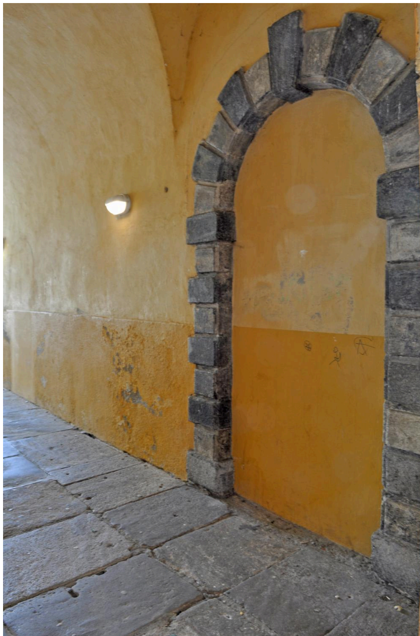
Bâtiment E : baie murée avant 1862
