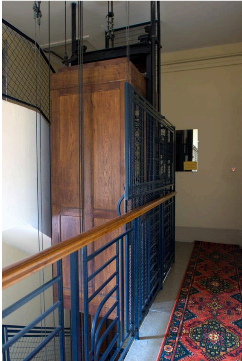
Cage et cabine de l'ascenseur, vue de dos
