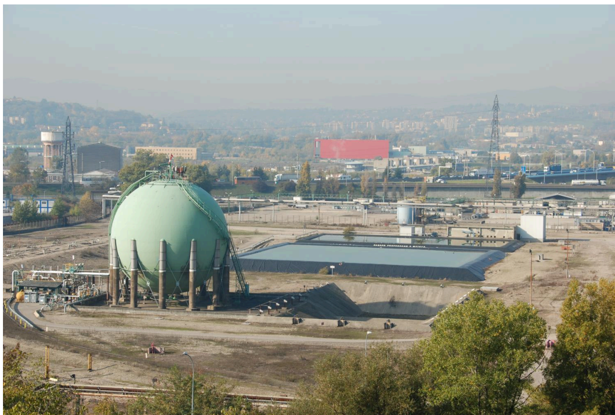
Réservoir sphérique, Elkem Silicones, 2009 (©BML : P1236 001 0169)
