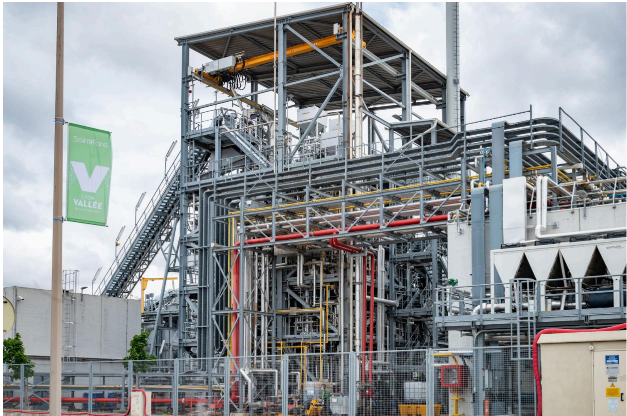
L'entreprise GAYA, Saint-Fons, 2021 (©Métropole de Lyon)
