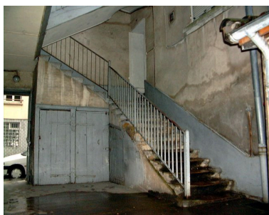
Départ de l'escalier contre la façade sur rue Phot. Bernard Ducouret IVR82_20006900534NUCA
