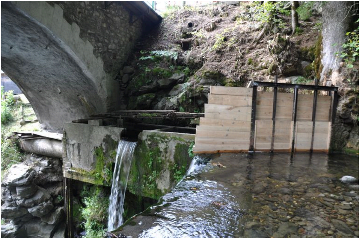
Vanne de régulation et bassin de mise en charge
