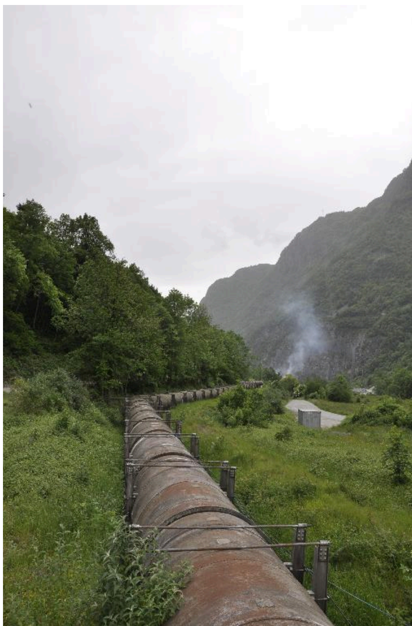
Vue de la conduite forcée menant l'eau à la centrale
