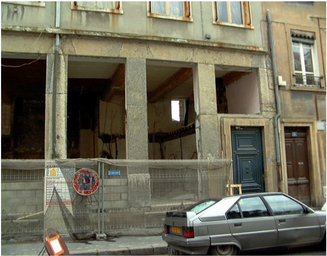
Détail de l'élévation du rez-de-chaussée côté rue de l'Alma, en cours de travaux
