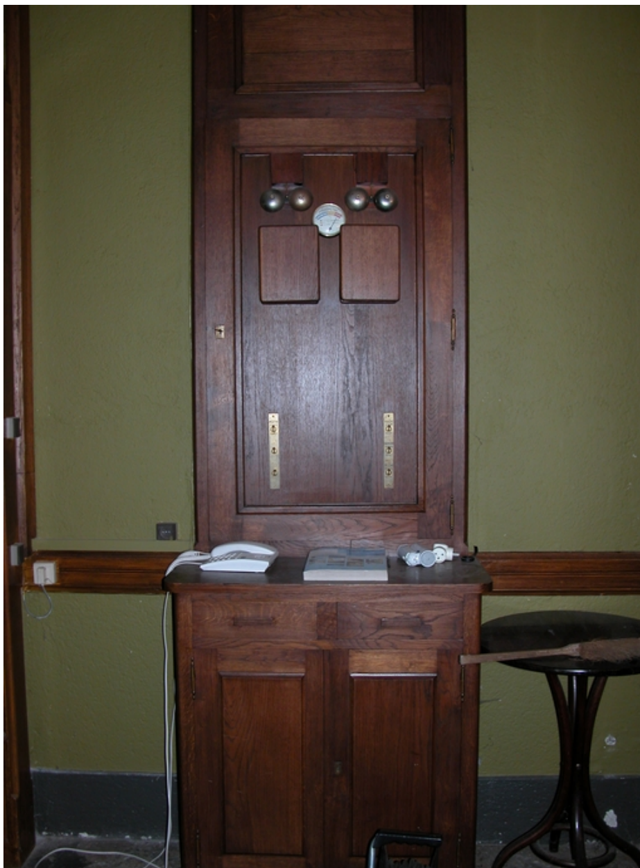
Vue du tableau de sonneries.
