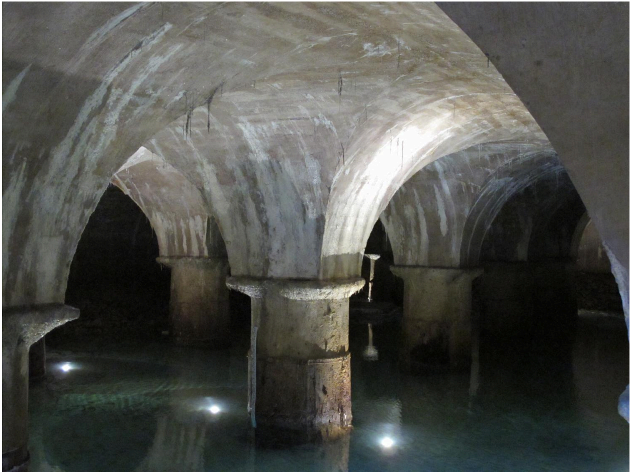
Détail bassins filtrants
