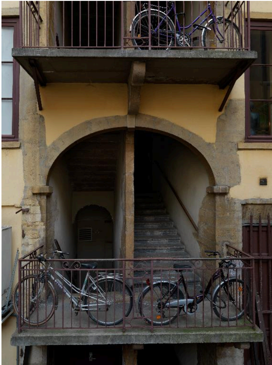
La cage d'escalier depuis la cour de la commanderie des Antonins : marques de pose et marques de tâcherons
