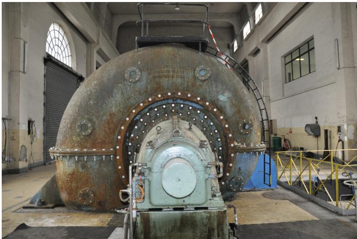
Bâche-turbine du groupe horizontal G1
