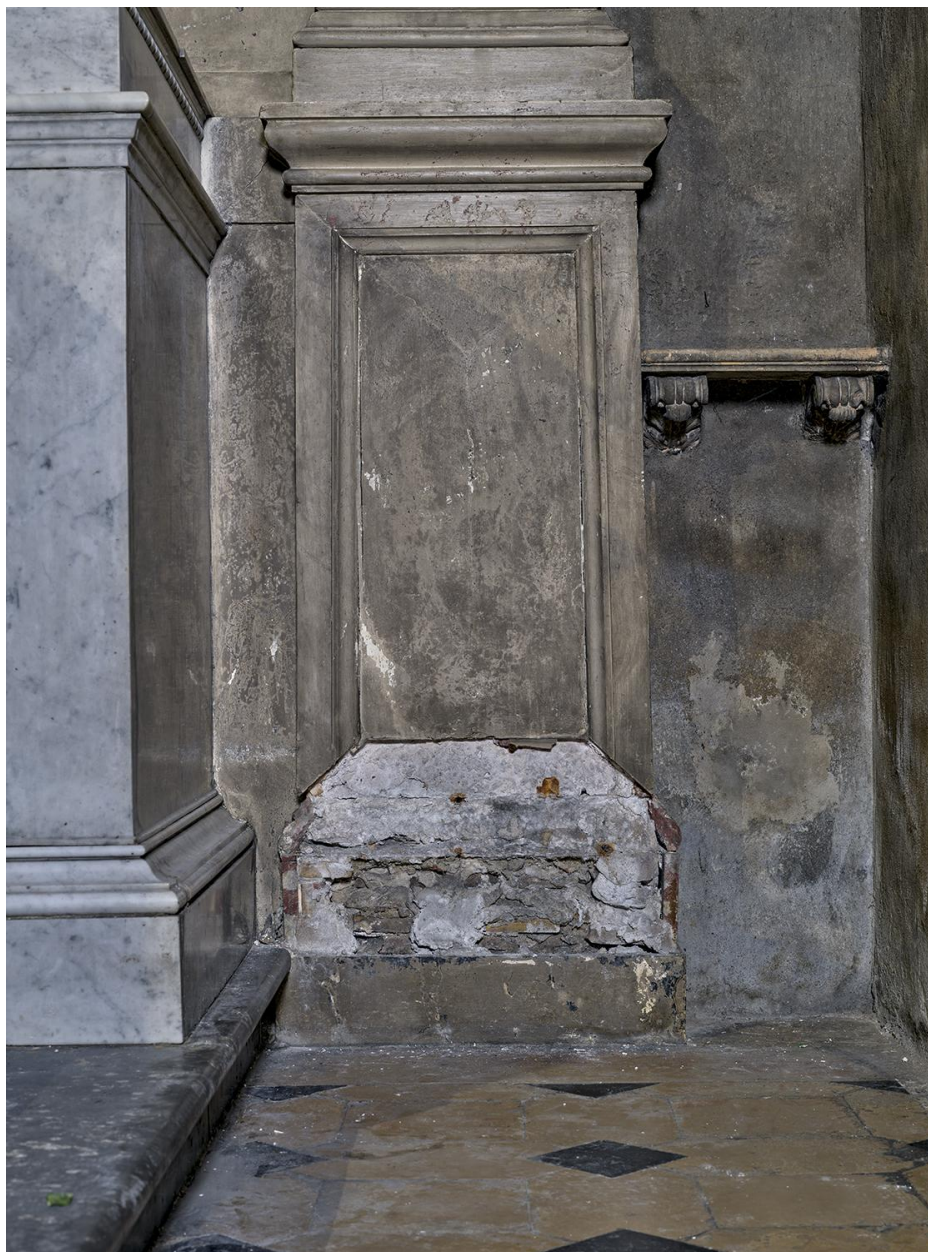
Détail de la partie endommagée
