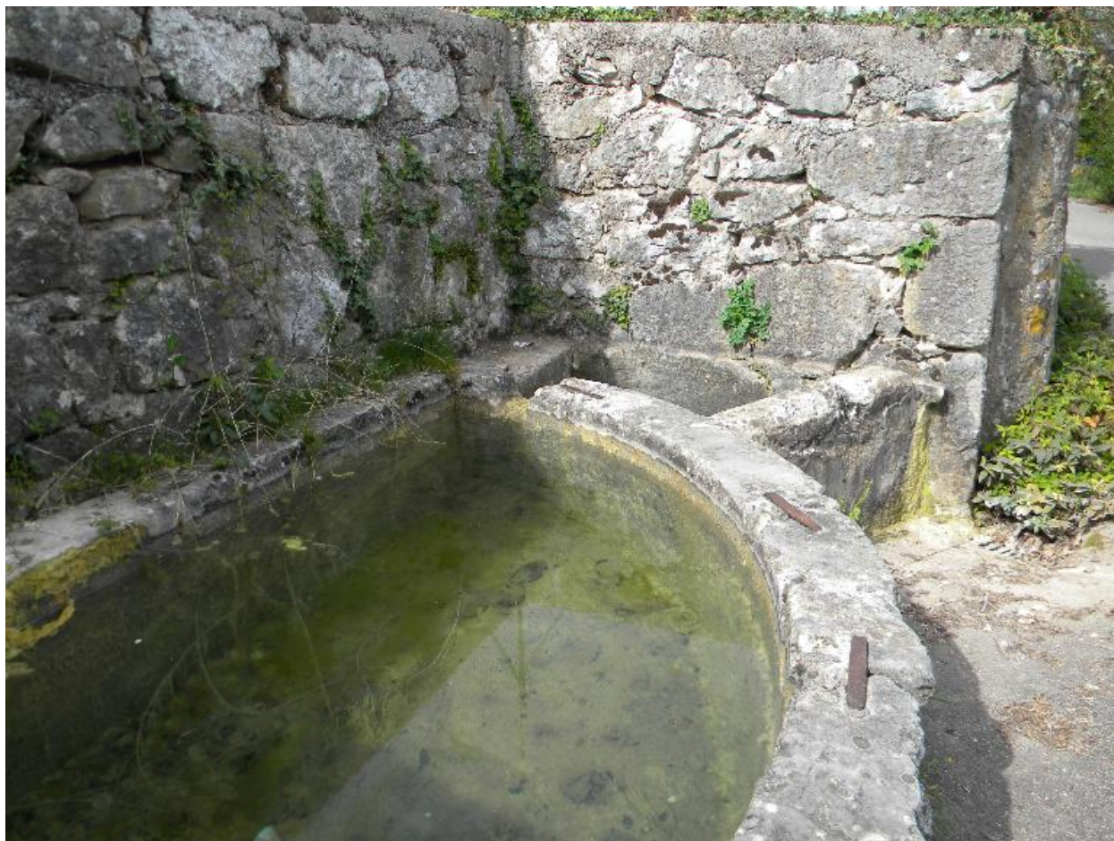
Vue de la jonction des deux réservoirs
