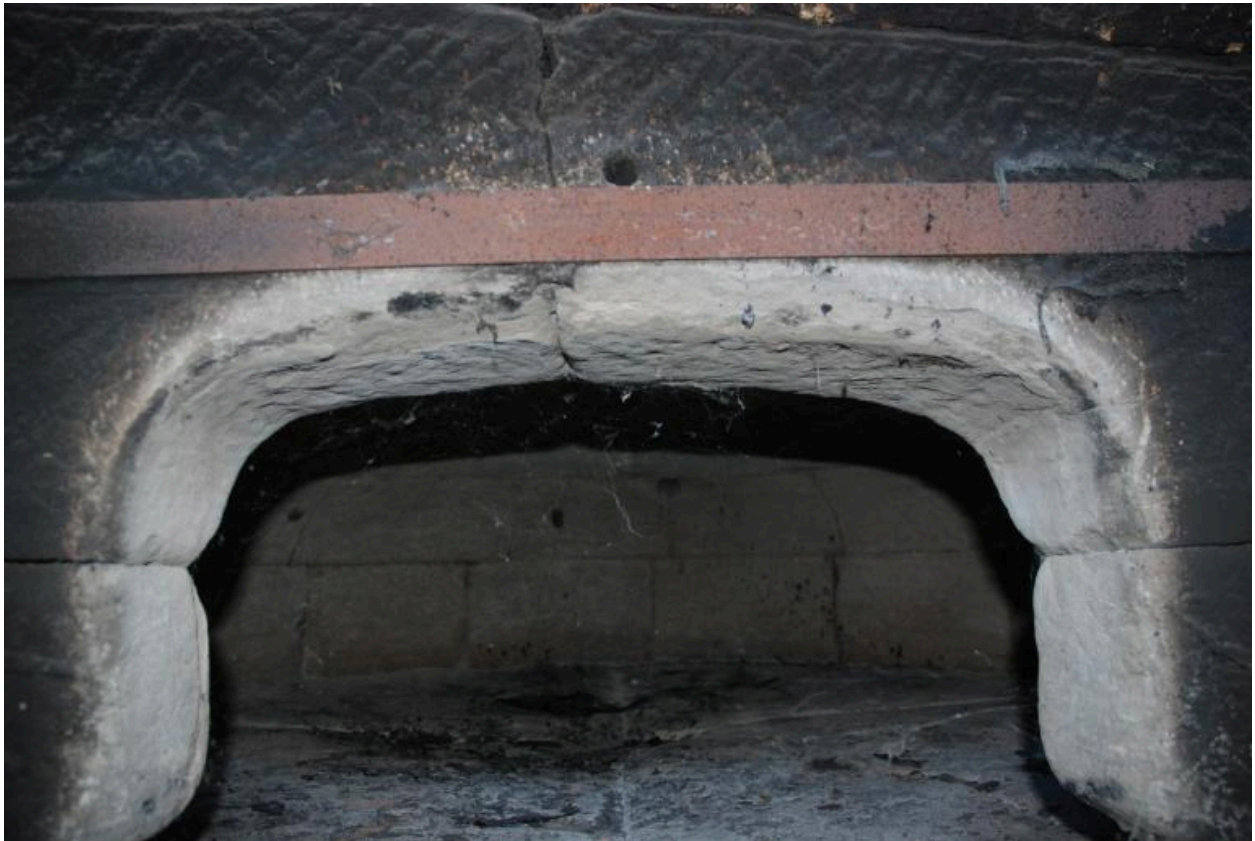
Vue de la bouche du four à pain.
