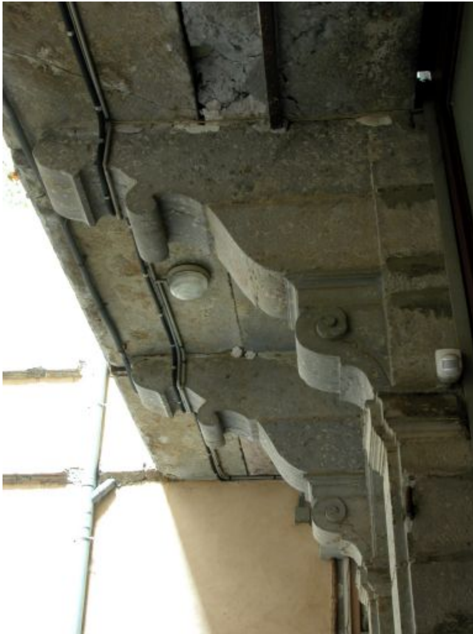
Cour, détail des consoles supportant le palier et la coursière du 3e étage
