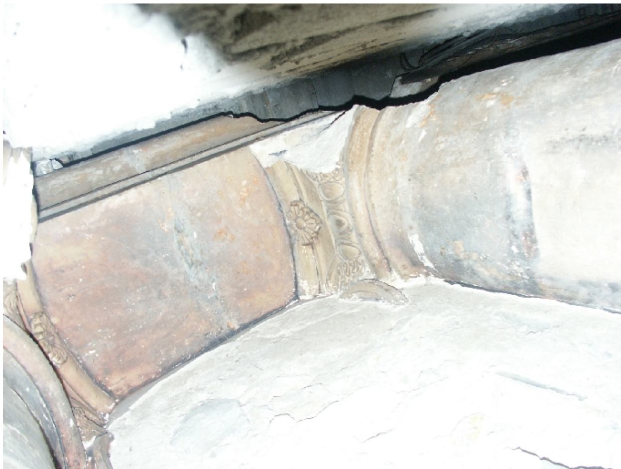
Colonnes avant restauration
