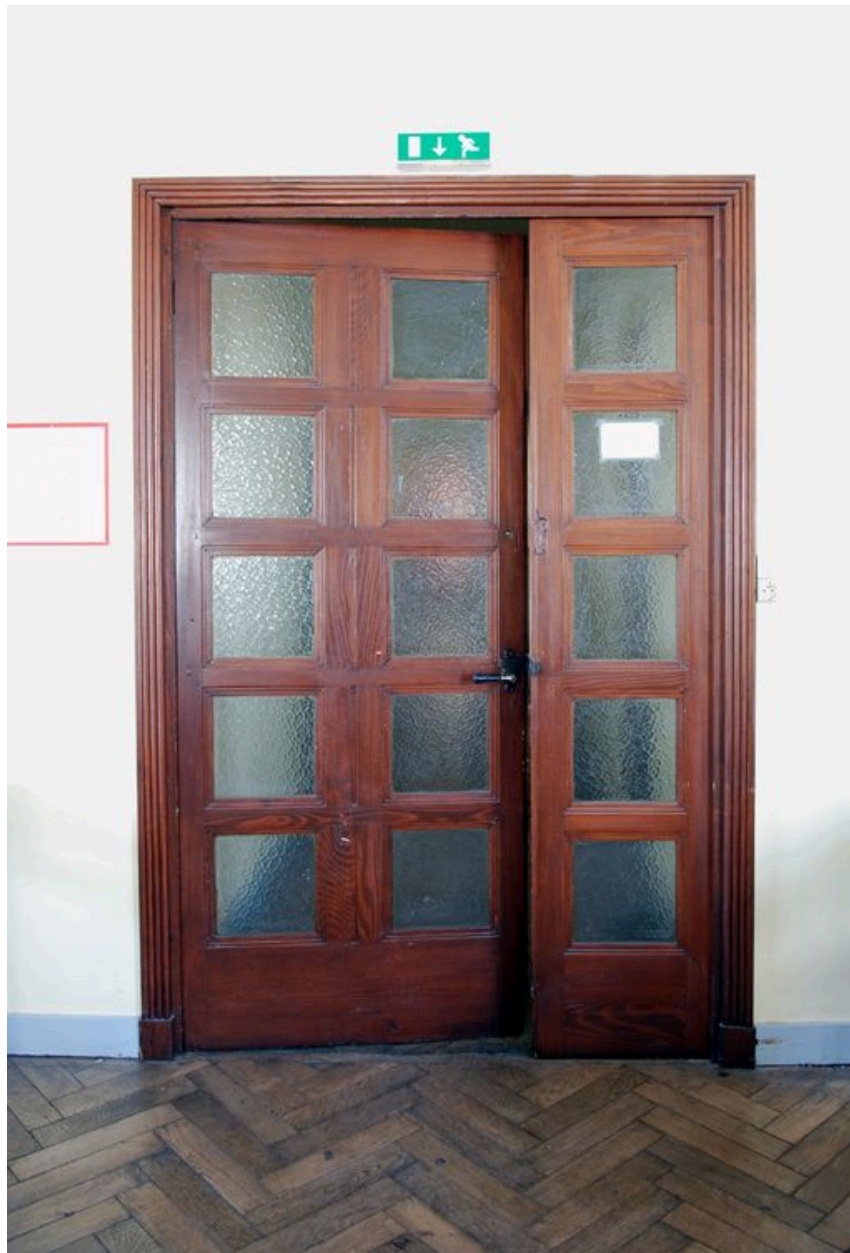
3e étage, salle de cours, extrémité de l'aile sud, détail de porte
