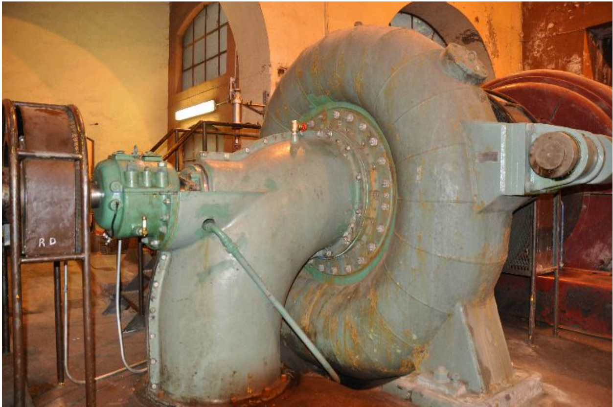
Détail d'une bache du groupe G4 (centrale de Livet)
