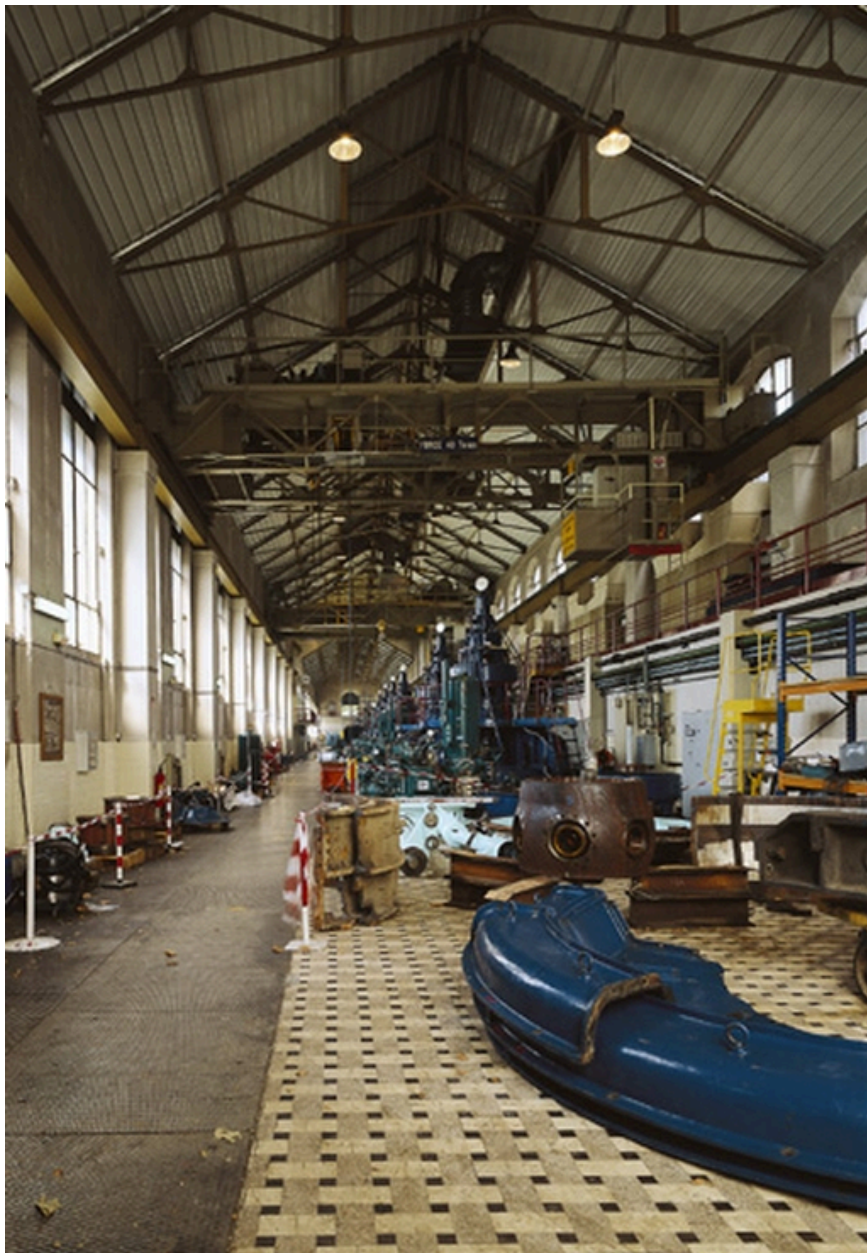
Salle des machines (ou salle des alternateurs), vue nord
