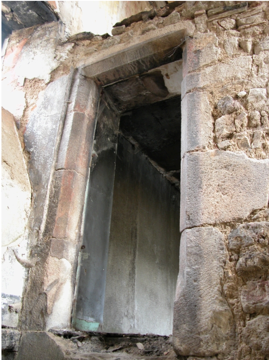
Vue intérieure du couloir de la partie est : porte à l'étage, côté ouest.
