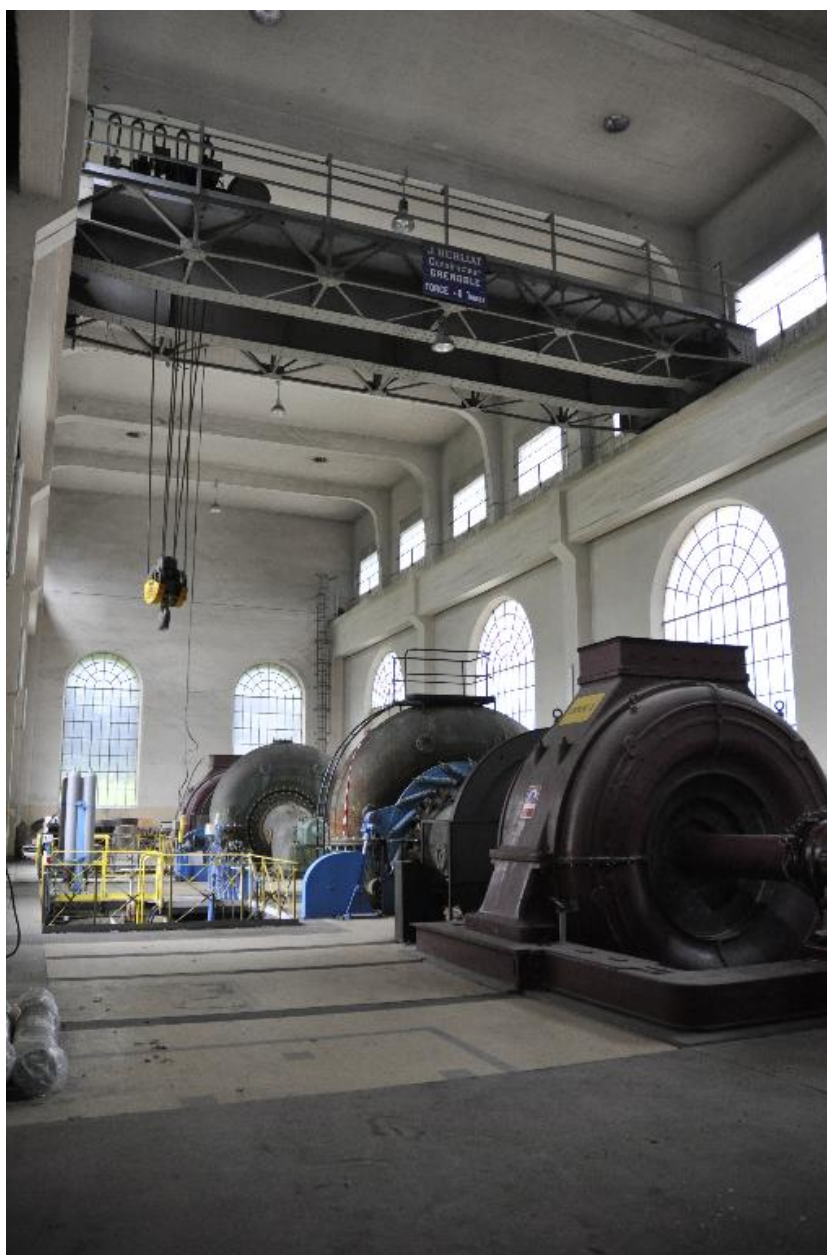
Vue de la salle des machines et du pont roulant
