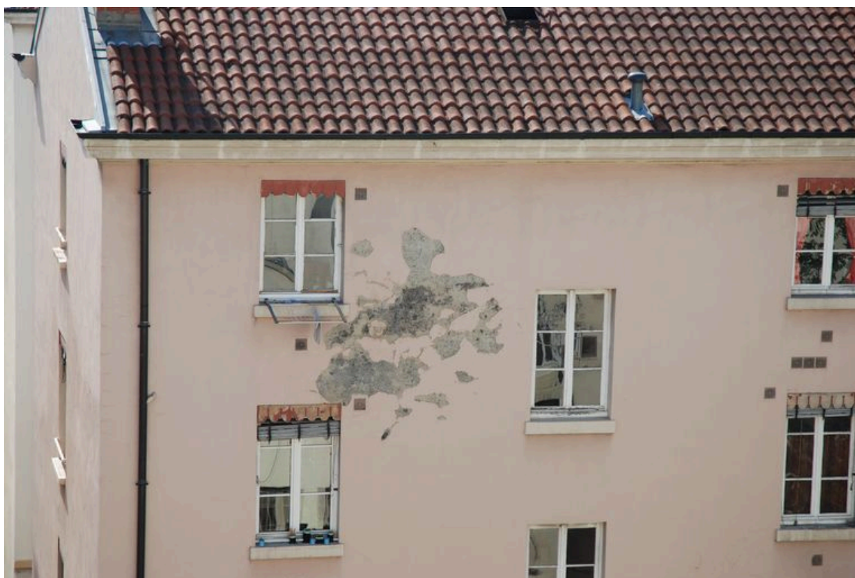
62 rue Pasteur, vue postérieure : mâchefer apparent dans une lacune de l'enduit
