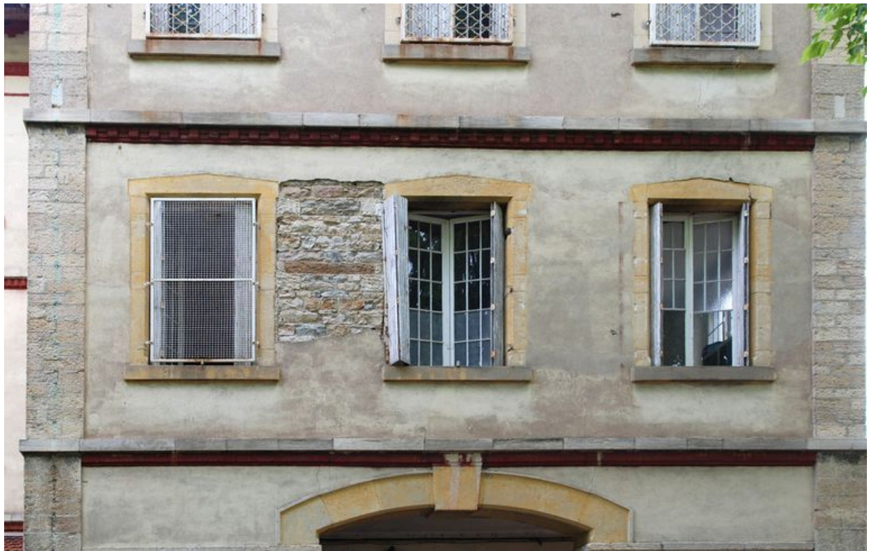
Façade principale, avant-corps latéral sud : enduit dégradé laissant apparaître la structure en moellons
