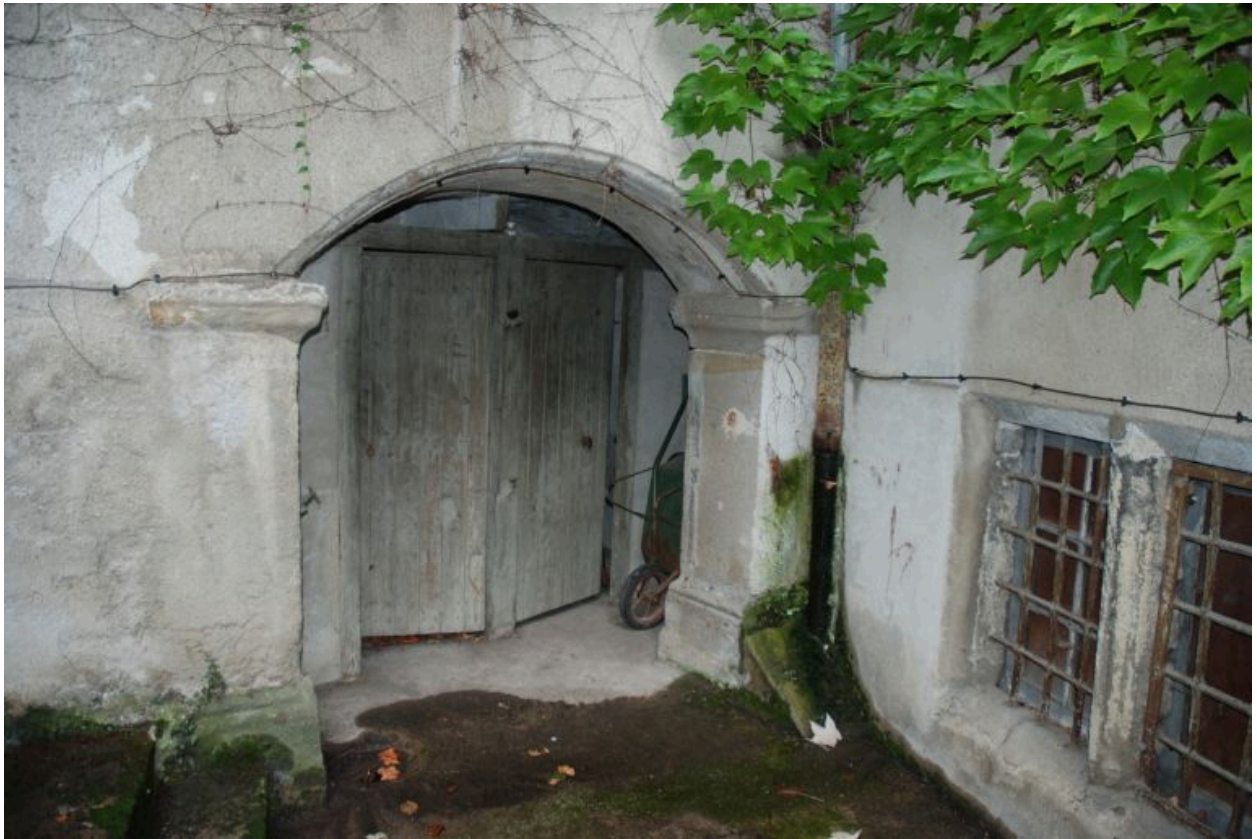
Cour anglaise, sorte de cour étroite qui dégage et donne jour et accès au sous-sol.
