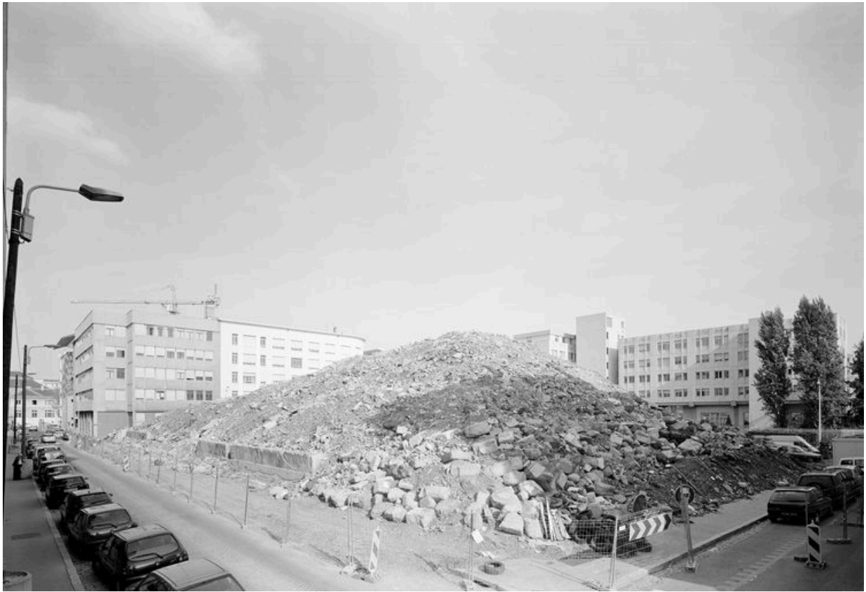
Vue générale après démolition, prise à l'angle des rues Raulin et du Professeur-Grignard
