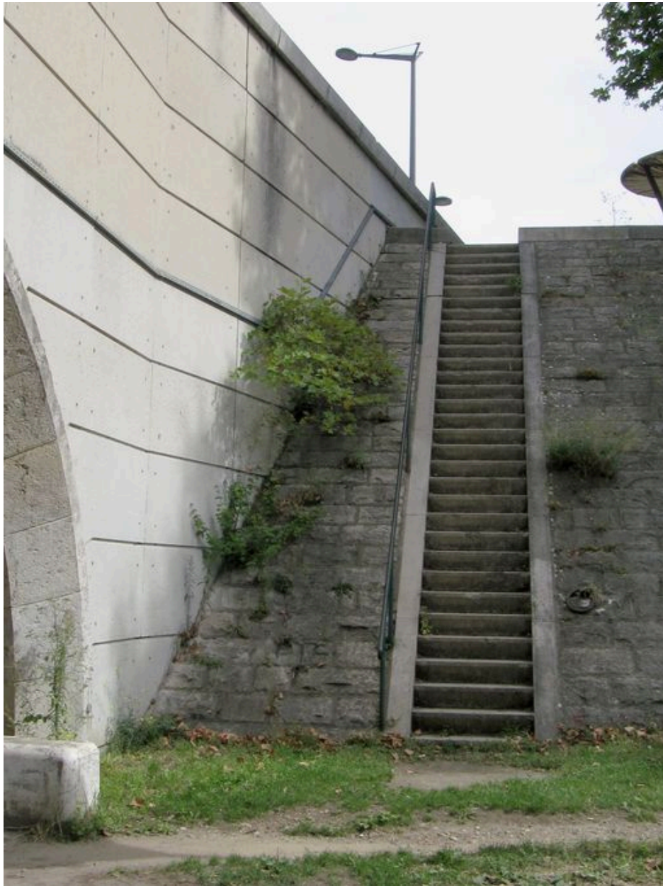
Escalier d'accès aux quais, face aval, vue générale (depuis la rive gauche)
