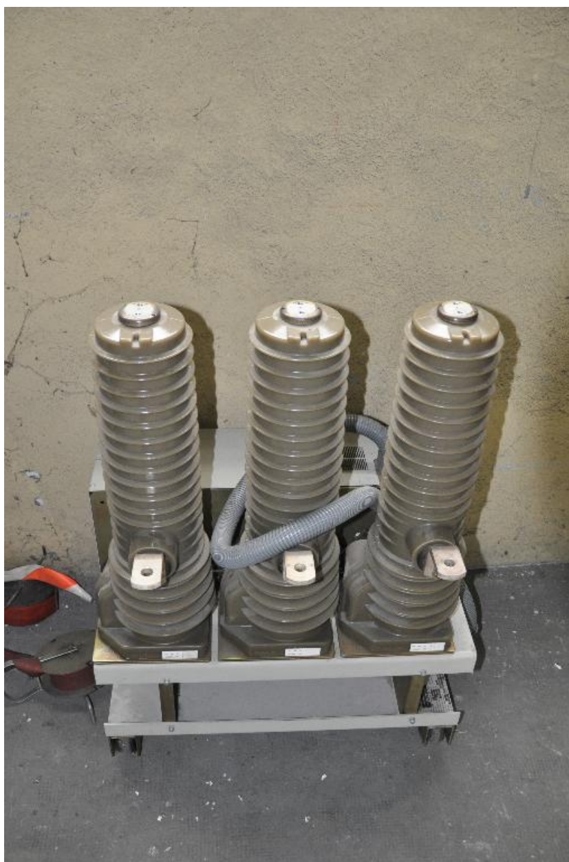
Vue du matériel électrique : dijoncteur
