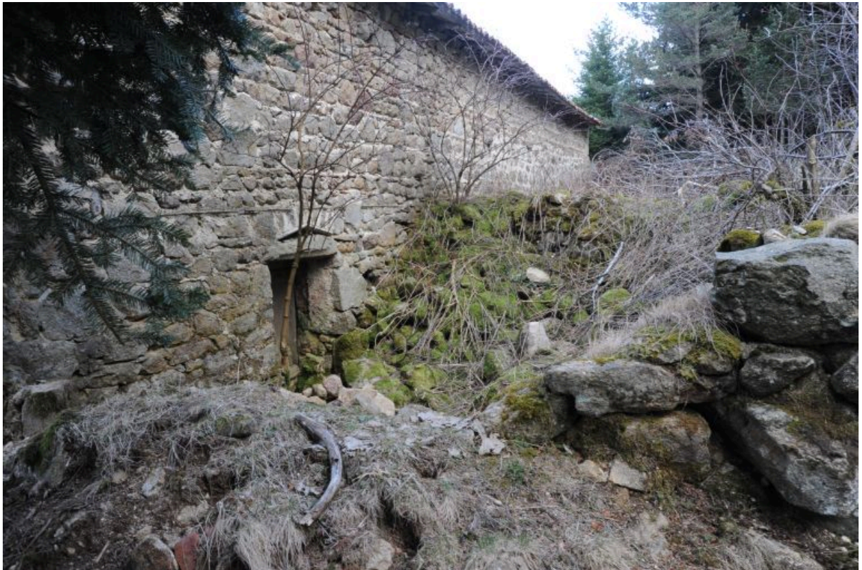
Mur gouttereau ouest, cave en ruine au premier plan.
