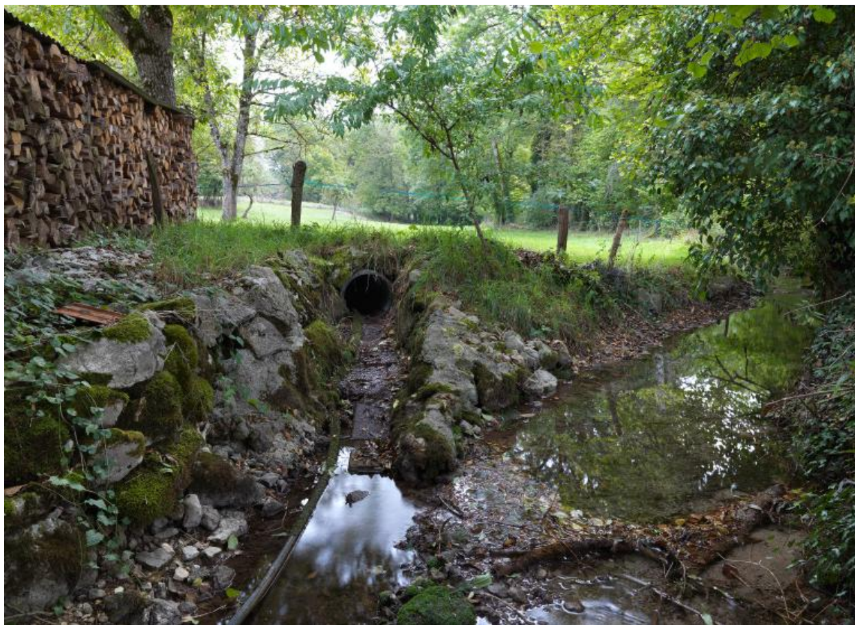
Vue du bief.
