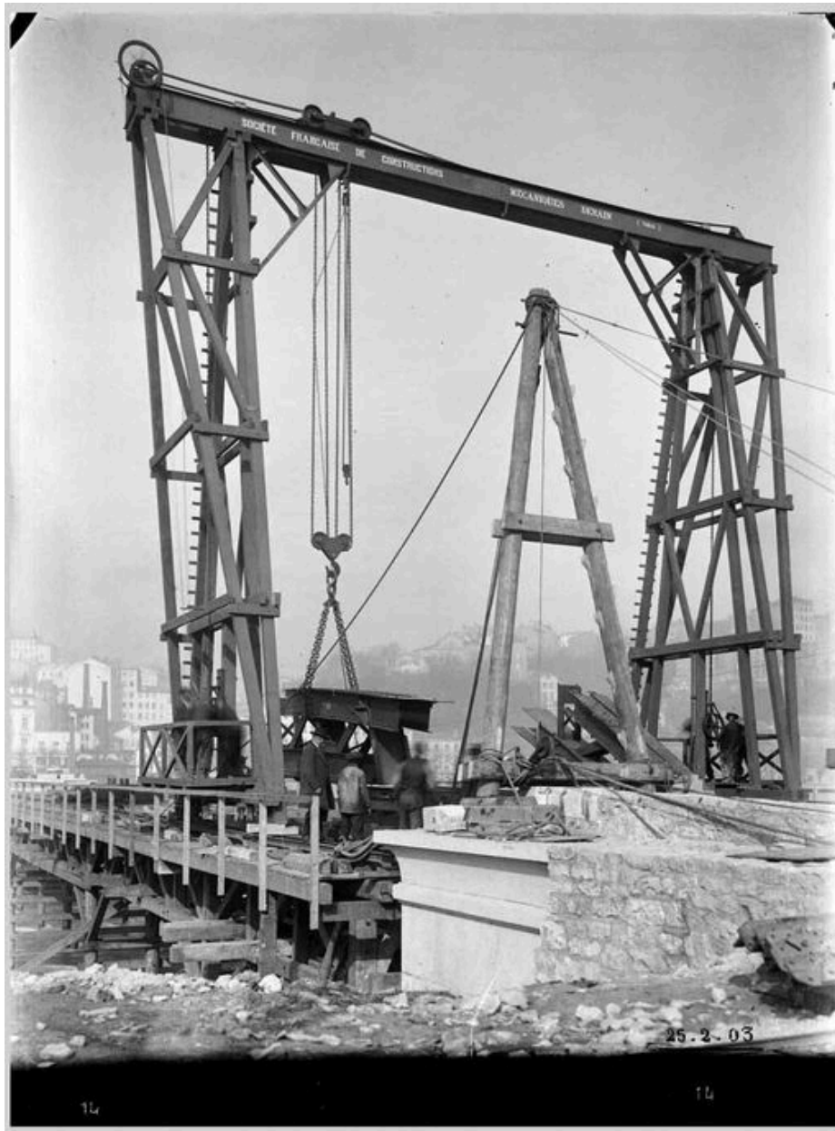
La construction du pont de la Boucle. La pose des poutrelles. 25 février 1903. 1 fotogr. : n. et b. (AM Lyon. 15 Ph 1810)
