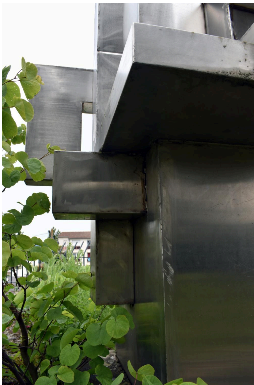
Détail des corrosions et salissures
