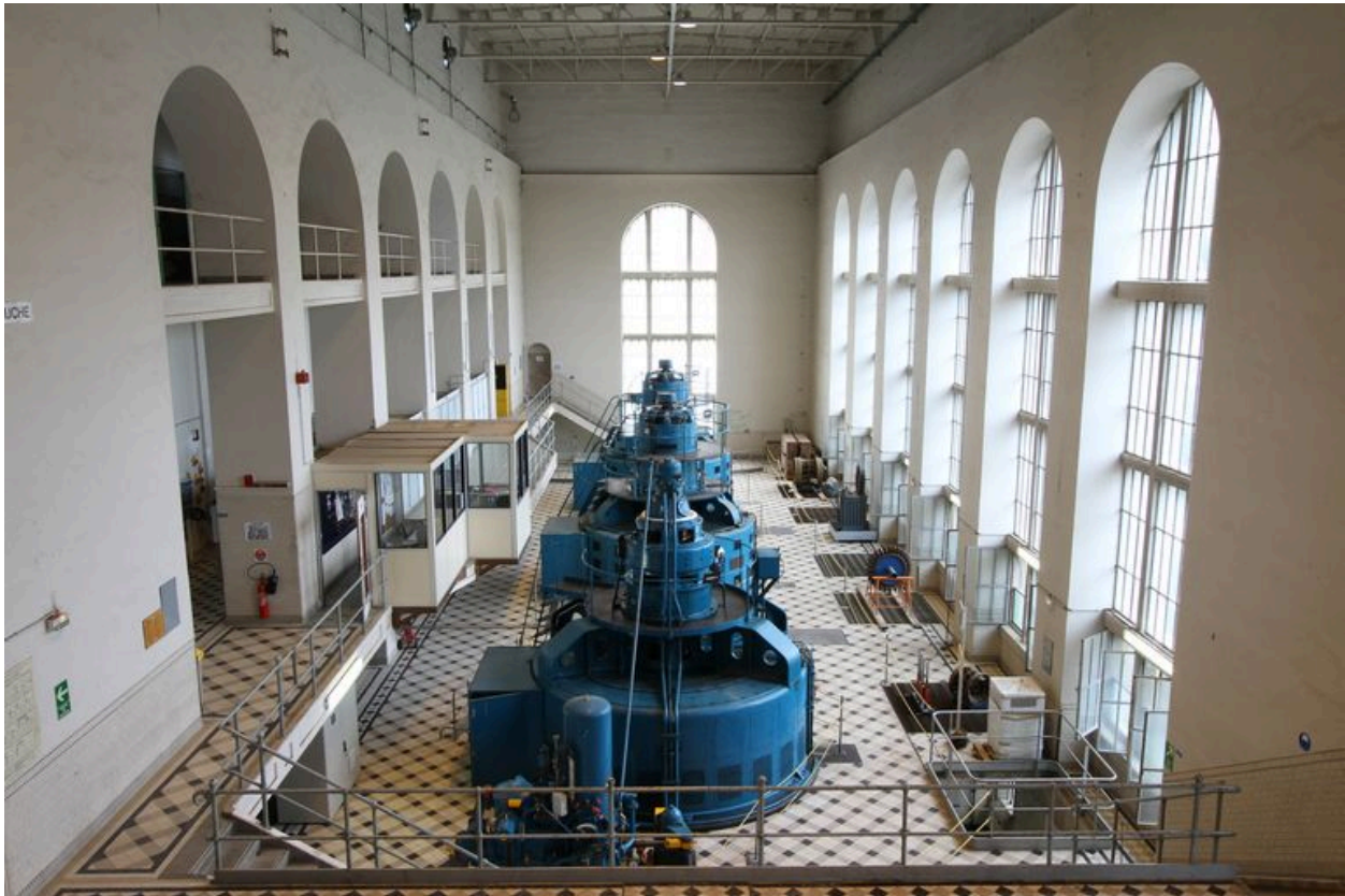
Salle des machines
