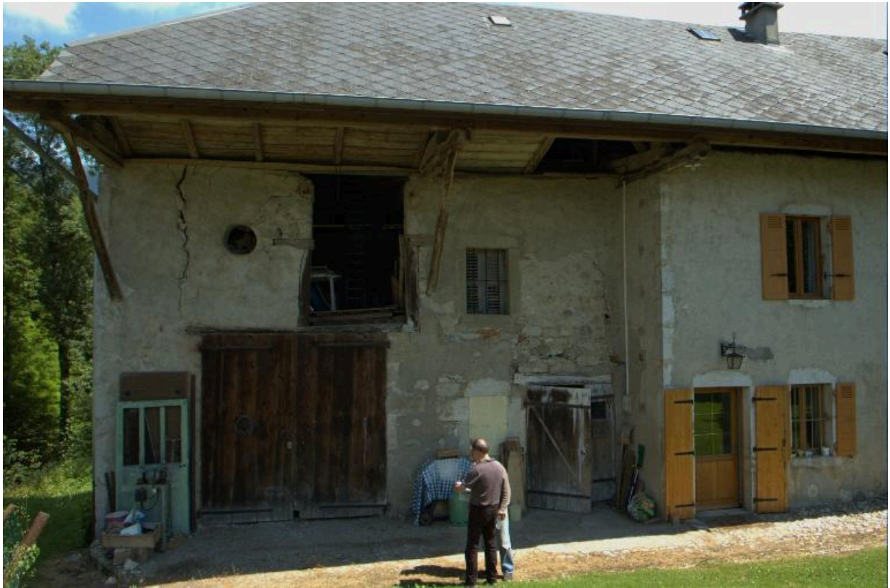
Vue partielle de la façade arrière de la ferme, grange-étable en renforcement.
